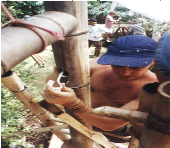
Figura 39: Detalhe da fixação das vigas através de barra rosqueável em forma de gancho.
