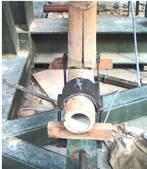
FOTO 26 FALLA SVM 90° TENSION
