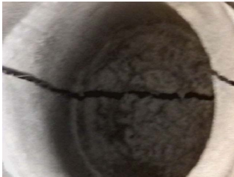
FOTO 31 VISTA LATERAL DE FALLA DG 90° TENSION
