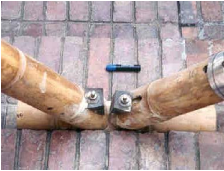
FOTO 38 VISTA SUPERIOR FALLA SVM 60°
