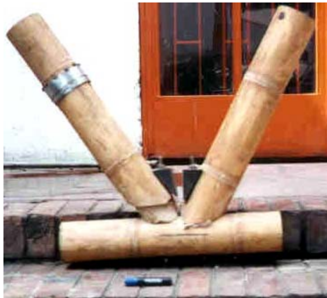
FOTO 37 FALLA UNION SVM 60°
