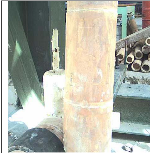
FOTO 27 FALLA SVM 90° POR LONGITUD DE DESARROLLO
