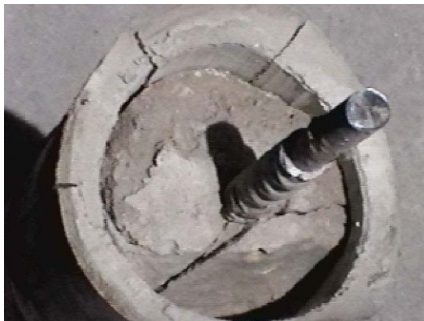
FOTO 42 DETALLE RUPTURA MORTERO DE RELLENO SVM 90°
